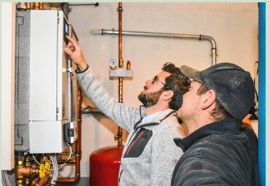
Florian Neufeld und Landwirt Andreas Riesch (v.l.) prüfen die neue Heizanlage, die den SVA an die Fernwärme vom Roberger-Hof anbindet.
